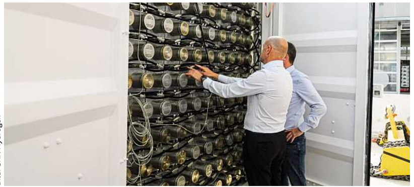
Blick ins Innere eines HY2MEGA-Speichers
